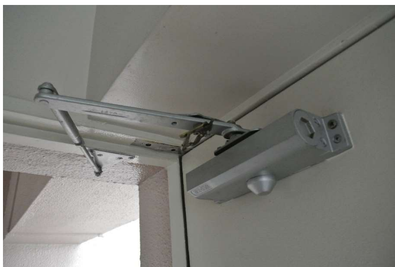
3階B階段側 ヒューズ交換前
