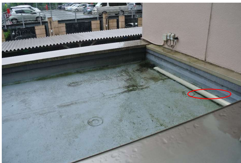
処置前 赤丸の付近まで雨水が溜りパイプが水中に埋もれた
